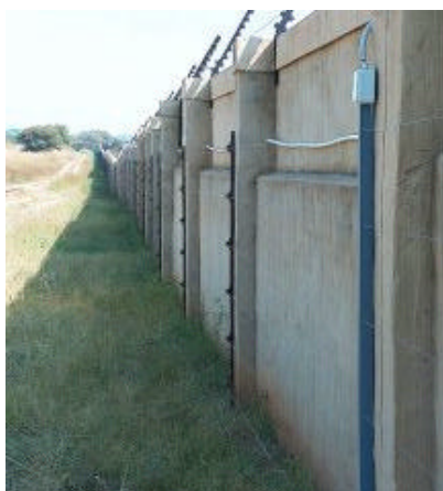
Voorbeeld van een 3Km muur Beveiligd met CDS systeem
